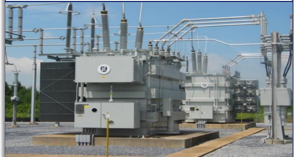
Transformador de potência utilizado numa subestação
