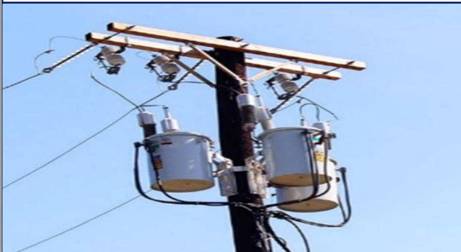
Transformador de distribuição em uso urbano
